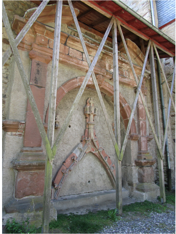
Abb. 9: Die letzten Relikte des historischen Sandsteinportals des Torgebäudes „Halber Mond“ am Oberen Schloss zu Siegen im Mai 2020. Foto: C. Brachthäuser.
